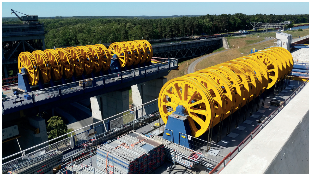
Widok na część ze 112 zainstalowanych podwójnych kół linowych. W tle po lewej stronie stara podnośnia.
