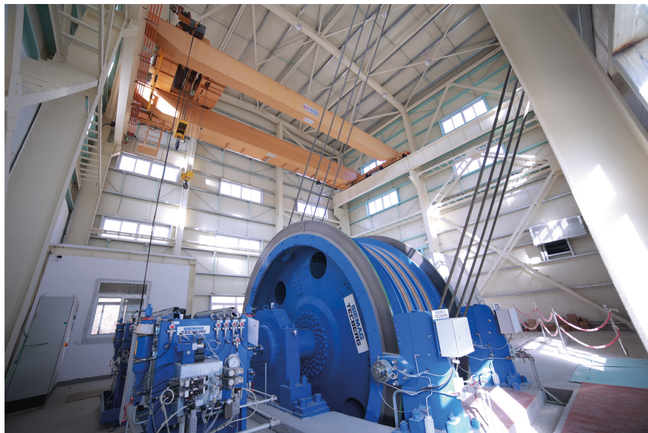
Рис. 2: четырехканатная подъемная машина системы Кёпе вспомогательного ствола также в эксплуатации.
