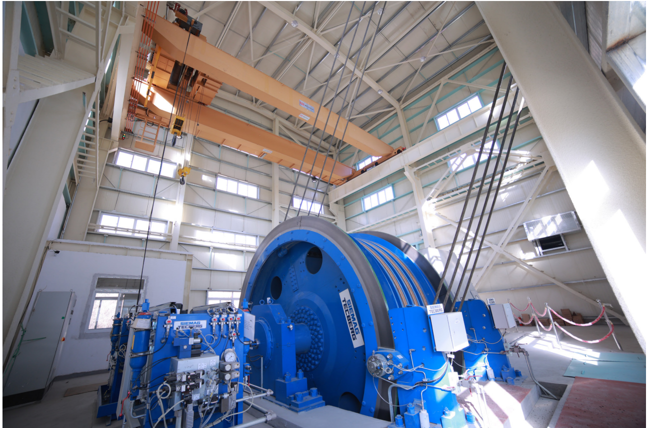
Abb. 2: Ebenfalls bereits in Betrieb - die 4-Seil Koepe Fördermaschine des Serviceschachts.
