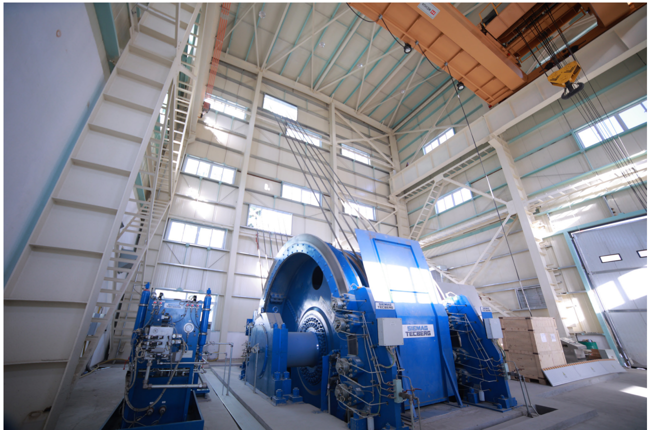
Abb. 1: Bereits in Betrieb - die 6-Seil Koepe Fördermaschine des Serviceschachts.
