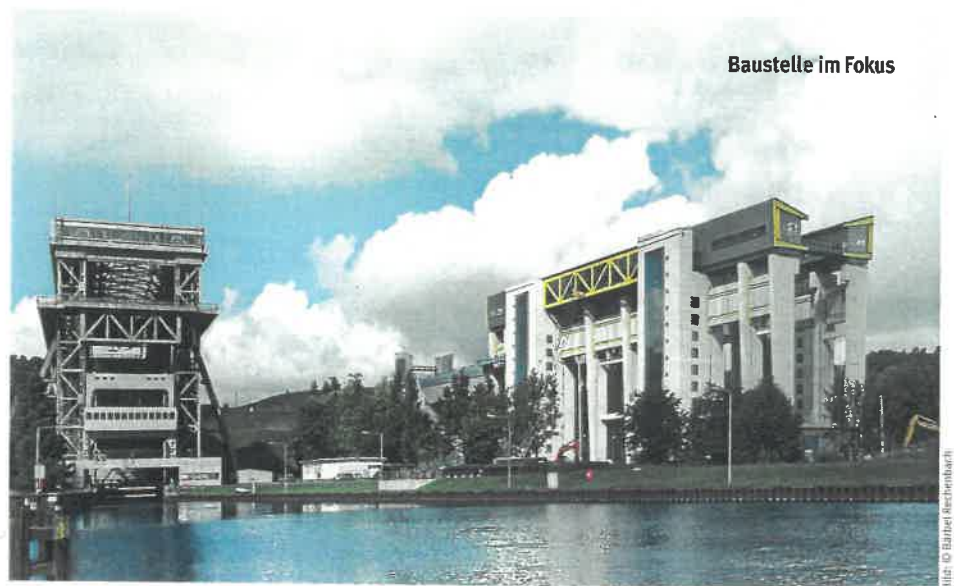
Historisches Bauwerk neben dem Neubau im September 2020, beide sind noch etwa fünf Jahre parallel in Betrieb.
